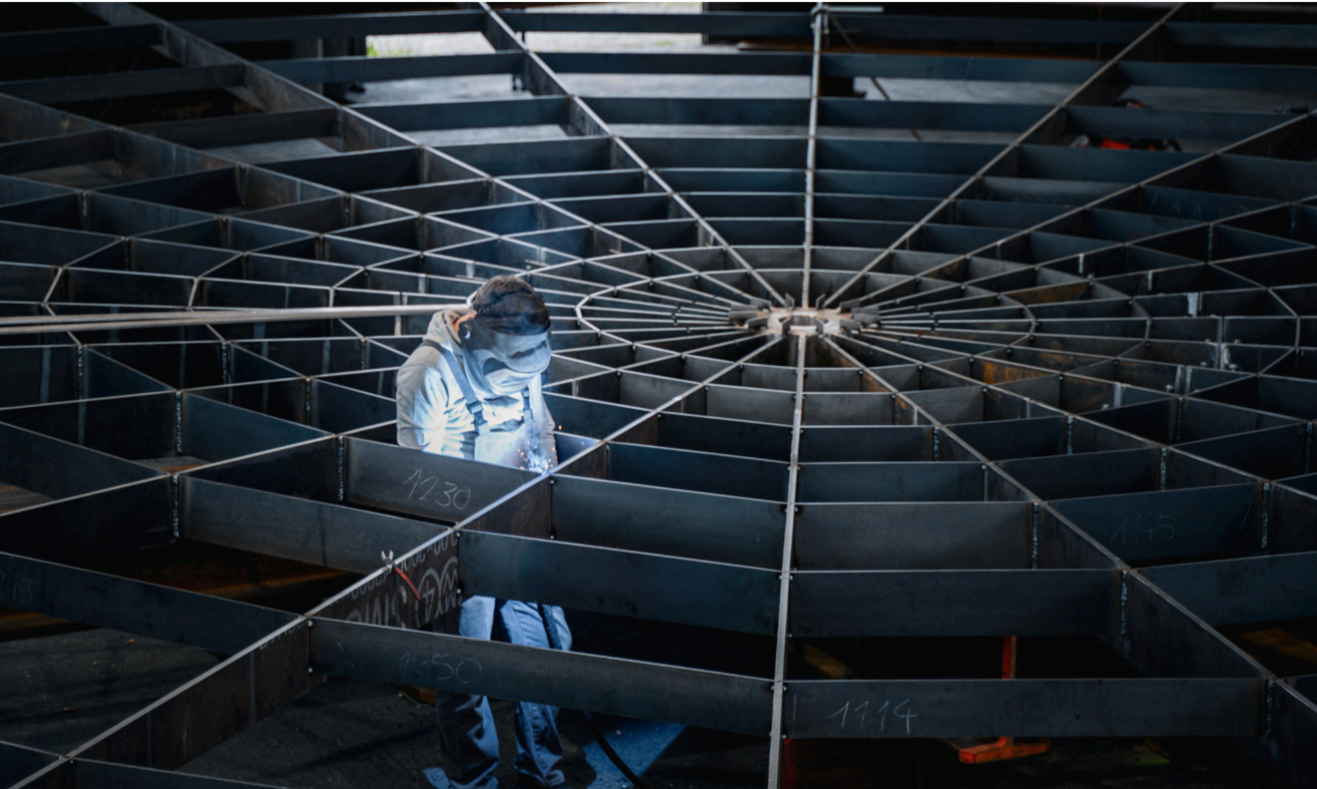
Für den Erweiterungsneubau Kantonsschule Urdorf stellte Baltensperger AG einen Pavillon mit einem verschweissten Stahldach her. (Foto: Baltensperger AG)
