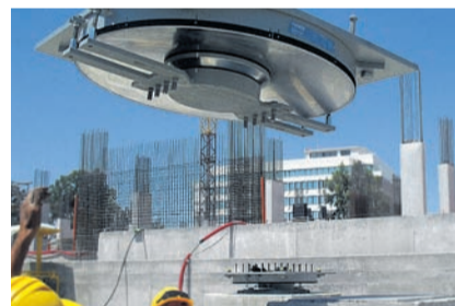
Einbau eines Erdbebenlagers von Mageba im Stavros Niachros Cultural Center in Athen
