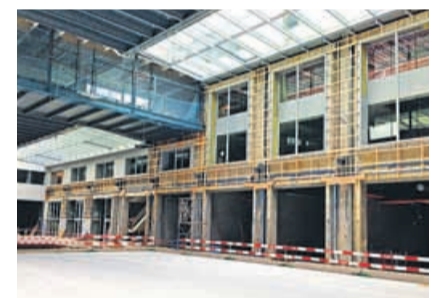
Ein Teil der Stahlkonstruktion in der Haupthalle des Innovationszentrums (links oben im Bild).
