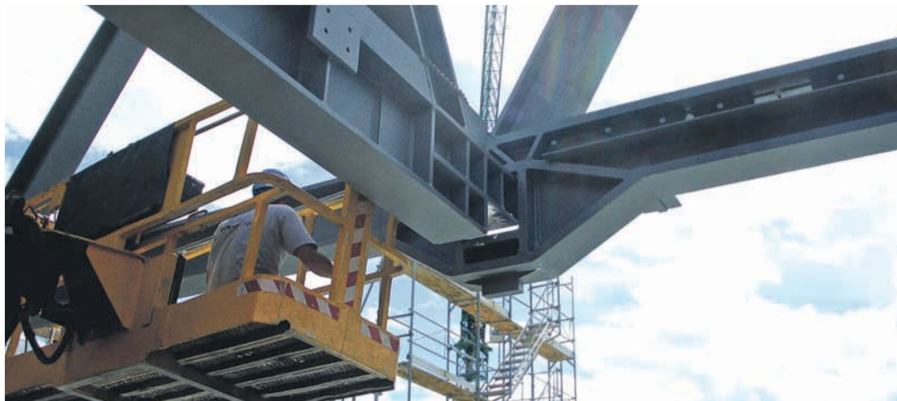
Ein Stahlträger wird in einen Knoten gesteckt. Die Stahlkonstruktion wurde von Baltensperger AG für das Innovationszentrum der Firma Hilti in Schaan (FL) hergestellt und montiert.
