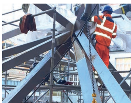
In der Schweiz einzigartige Spinnwebenstahlkonstruktion für die Erdbebenstabilisierung des Löwenhof-Gebäudes in Zürich.
